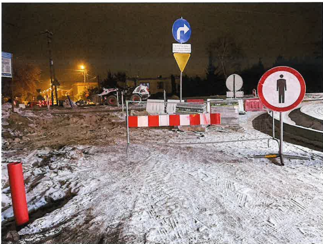
Mylące, nieprawidłowe oznakowanie zamkniętego skrzyżowania. Kierowcy dojeżdżający do tego miejsca, zmuszeni są wykonywać karkołomne manewry w celu zawrócenia i szukania objazdu.
